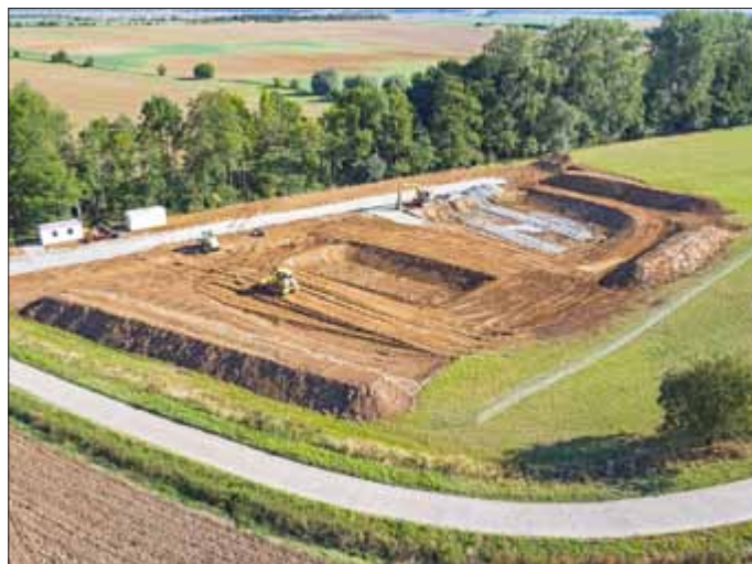
Mit dem Neubau der Kläranlage Schildbach entsteht eine zentrale, vollbiologische Kläranlage für 2.400 Einwohnerwerte.
